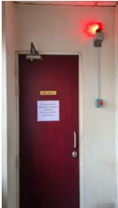
房外的警示灯亮起显示空气处理机组里的紫外线C 已操作
