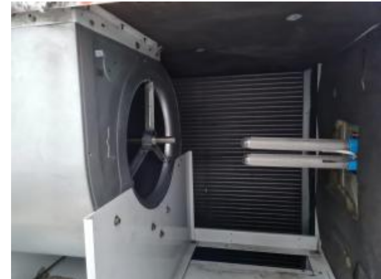
净离子群安装于中央空调的位置
